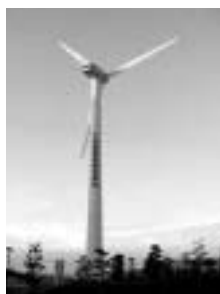
●日本食品(株)の風力発電施設
