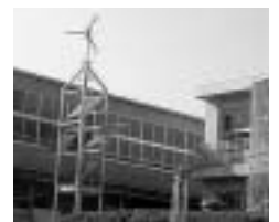
●東広瀬小学校の風力発電装置
