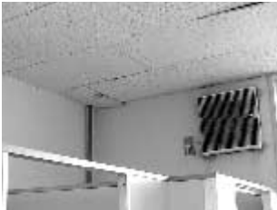
壊れてははずれそうな天井(井郷中)
