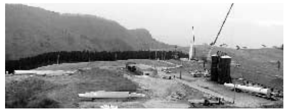
稲武町面ノ木地区の風力発電施設全景 (H16.12.12撮影)
