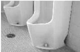
壊れたままの便器(井郷中)
