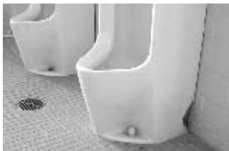
壊れたままの便器(井郷中)
