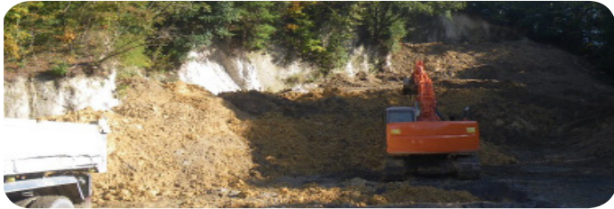
無農薬農園の造成と称して建設残土が搬入されている現場(藤岡地区北一色町)
